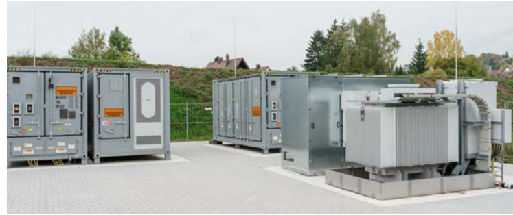
Der neue Batteriespeicher in Feuchtwangen
